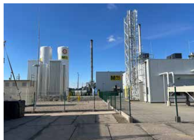
Dzięki powstaniu kogeneracji przy ul. Stefczyka stopniowo wygaszana będzie kotłownia węglowa przy ul. Kościelnej
