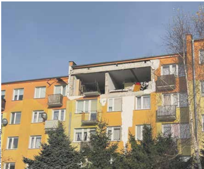
Siła wybuchu była tak duża, że z dwóch stron budynku zniszczone zostały ściany
